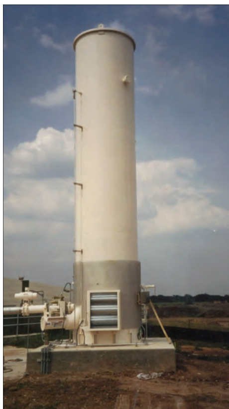
Закрытый наземный факел
