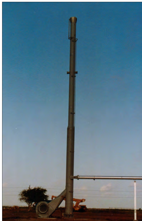
Самоподдерживающийся факел с воздушной подачей
